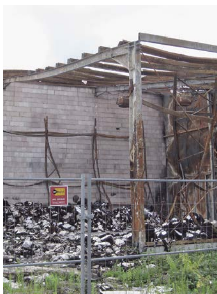
Bild 10 Durch Brand verformte Stahlkonstruktion vor unversehrter Kalksandsteinwand
