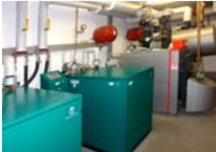
BHKW und Kessel in der Heizzentrale
