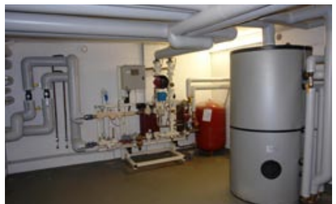
Heizanlage – Übergabestation Fernwärme
