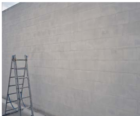
Bild 8 Geschlämmtes KS-Mauerwerk mit KS-Plansteinen
