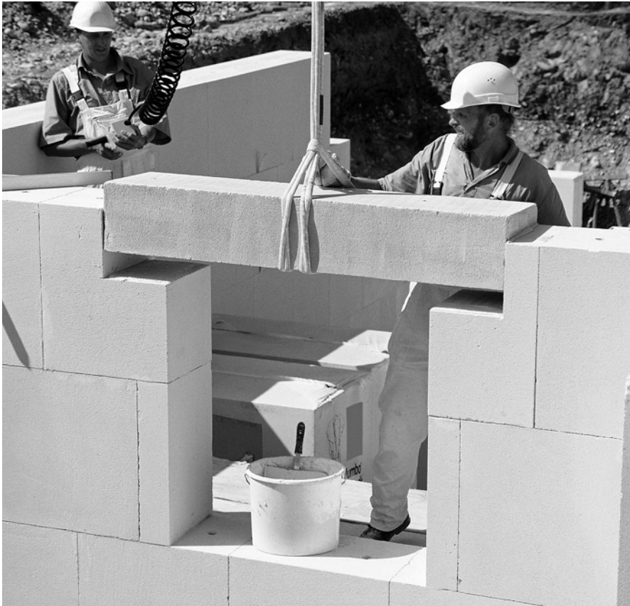
Abb. 5.5: Einbau von Porenbetonstürzen der Feuerwiderstandsklasse F 90 – Benennung: F 90-A
