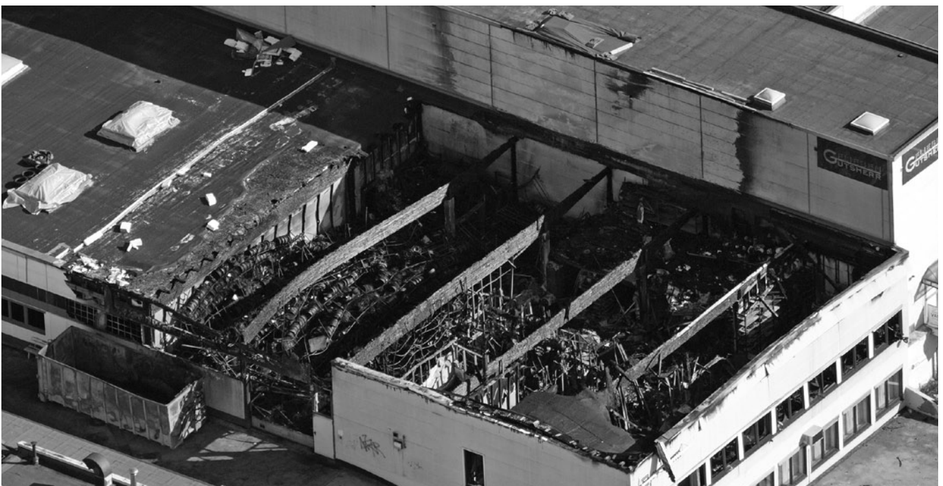
Abb. 9.5: Brand einer Reifen-Lagerhalle: Durch die Brandwand aus Porenbeton konnte trotz der extrem hohen Brandbeanspruchung ein Übergriff des Brandes auf den benachbarten Industriebaukomplex verhindert werden.
