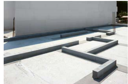
Die fertige Kimmschicht erlaubt einen Eindruck vom Grundriss und bietet den planebenen Untergrund für das weitere Mauerwerk.
