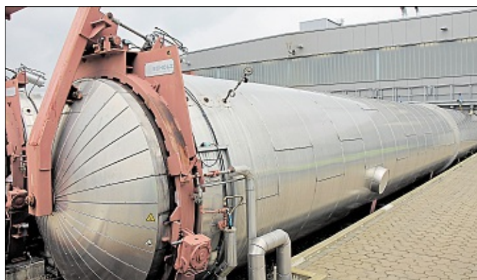
Imposant: Insgesamt fünf Autoklaven sind verbaut.
