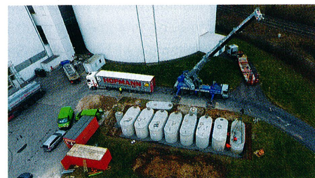
Am Nordzucker-Standort in Wierthe in der Nähe von Braunschweig können acht miteinander verbundene Ovalbehälter einen Löschwasservorrat von 220 m 3 aufnehmen. | Foto: Mall
