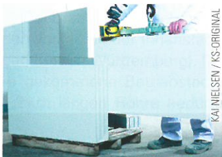
Fast ohne körperliche Anstrengung erstellt der Maurer mit einem Hub bis zu 0,65 m 2 Mauerwerk.
